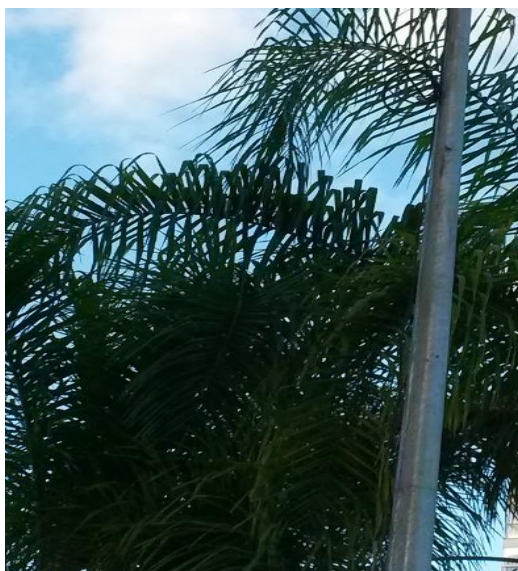
Figura 9 - Poste de metal com luminária localizado na Praça Sesquicentenário Brusque-SC
