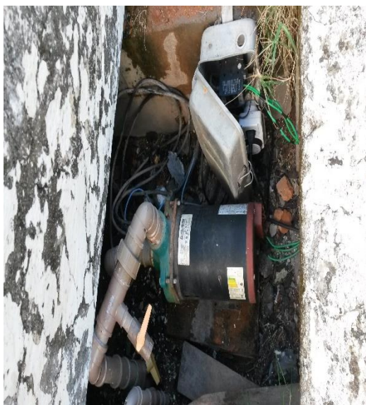
Figura 3 - Quadro de fiação e motor, Praça Theodoro Debatin, Centro de Guabiruba-SC
