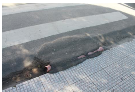
Figura 06: transição de travessia elevada para passeio em frente a E.M.E.F. Prof. José Vieira Corte, antes da adaptação.
