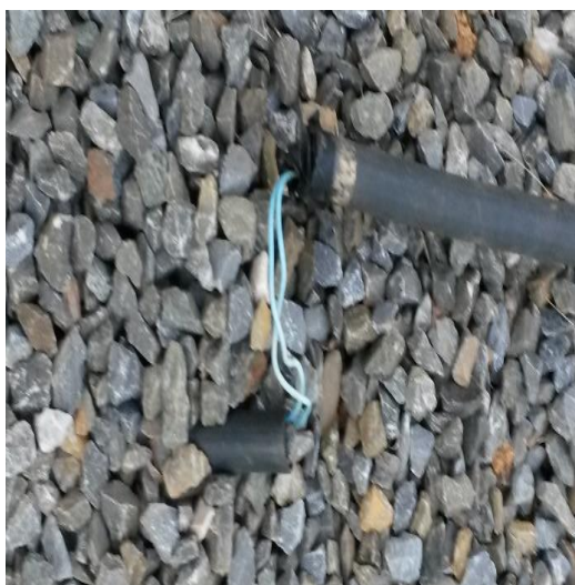
Figura 11 - Fio com seu conduto rompido
