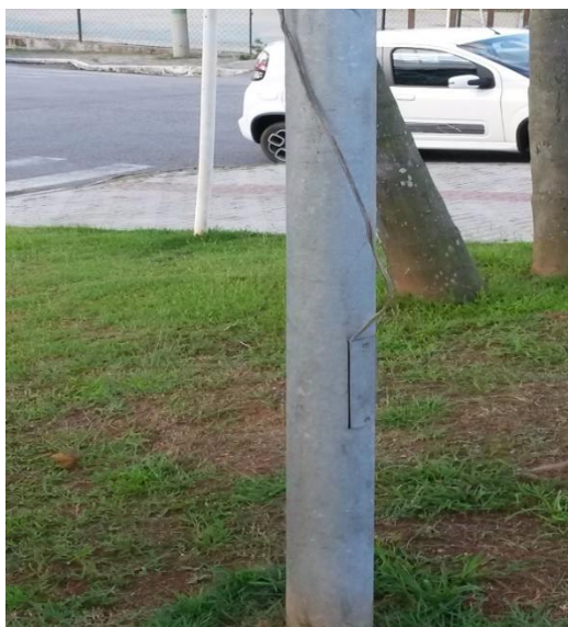
Figura 10 - Fio exposto saindo da parte interna do poste
