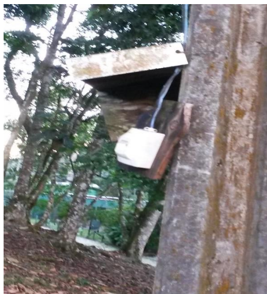
Figura 12 - Tomada instalada de forma inadequada
