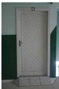
Figura 07: Porta com desnível ao acessar ambiente, solucionado de forma incorreta, na E.E.F. Lions Clube Comp. Oscar Maluche. Fonte: Acervo pessoal. Data: 30 jul. 2014.
