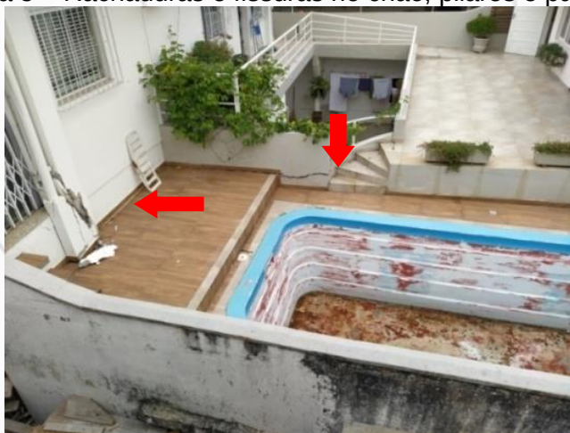
Figura 5 – Rachaduras e fissuras no chão, pilares e paredes.
