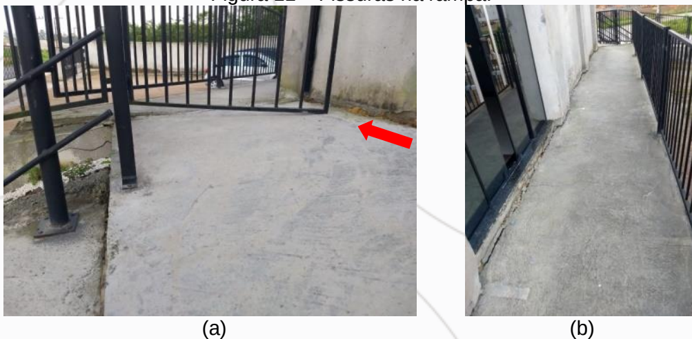
Figura 11 – Fissuras na rampa.
