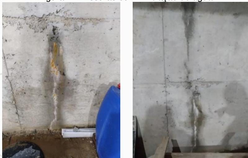
Figura 7 – Fissuras com infiltração de água.
