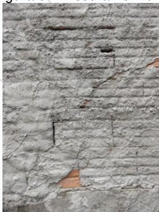
Figura 8 – Fissura no muro.
